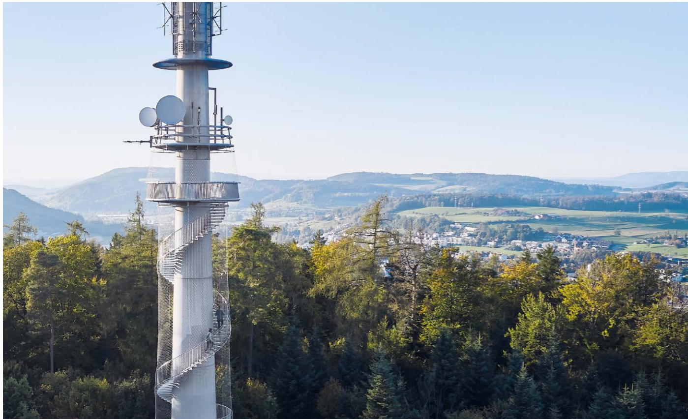
Vertikale Absturzsicherung | Brühlbergturm Winterthur, Schweiz Protection verticale contre les chutes | Brühlbergturm de Winterthur, Suisse Vertical fall protection | Brühlbergturm Winterthur, Switzerland
